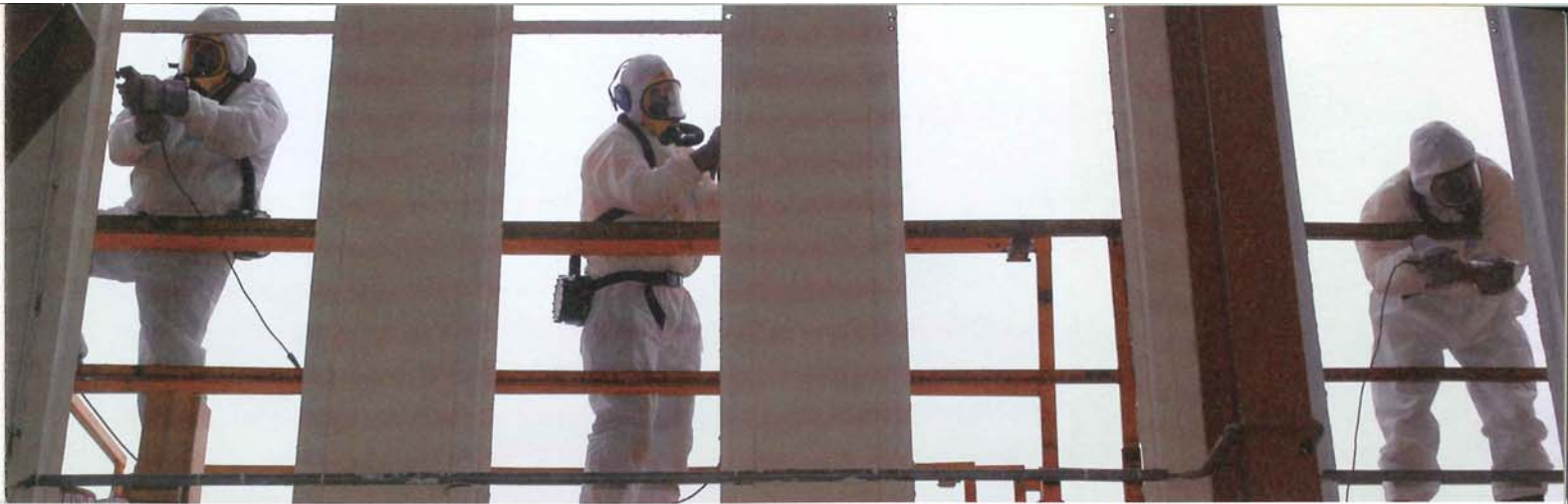
Asbestvrij maken van de voormalige RDM-werf in Rotterdam. Een deel van de werf wordt een campus van de Hogeschool Rotterdam.
