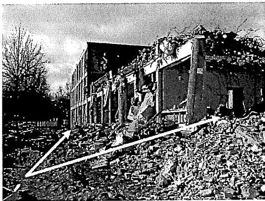
7. verontreinigt terrein rond gesloopt gebouw
